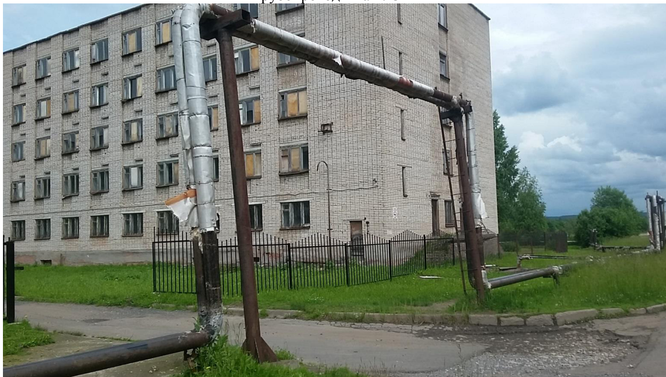
Трубопроводы на п. СХТ
