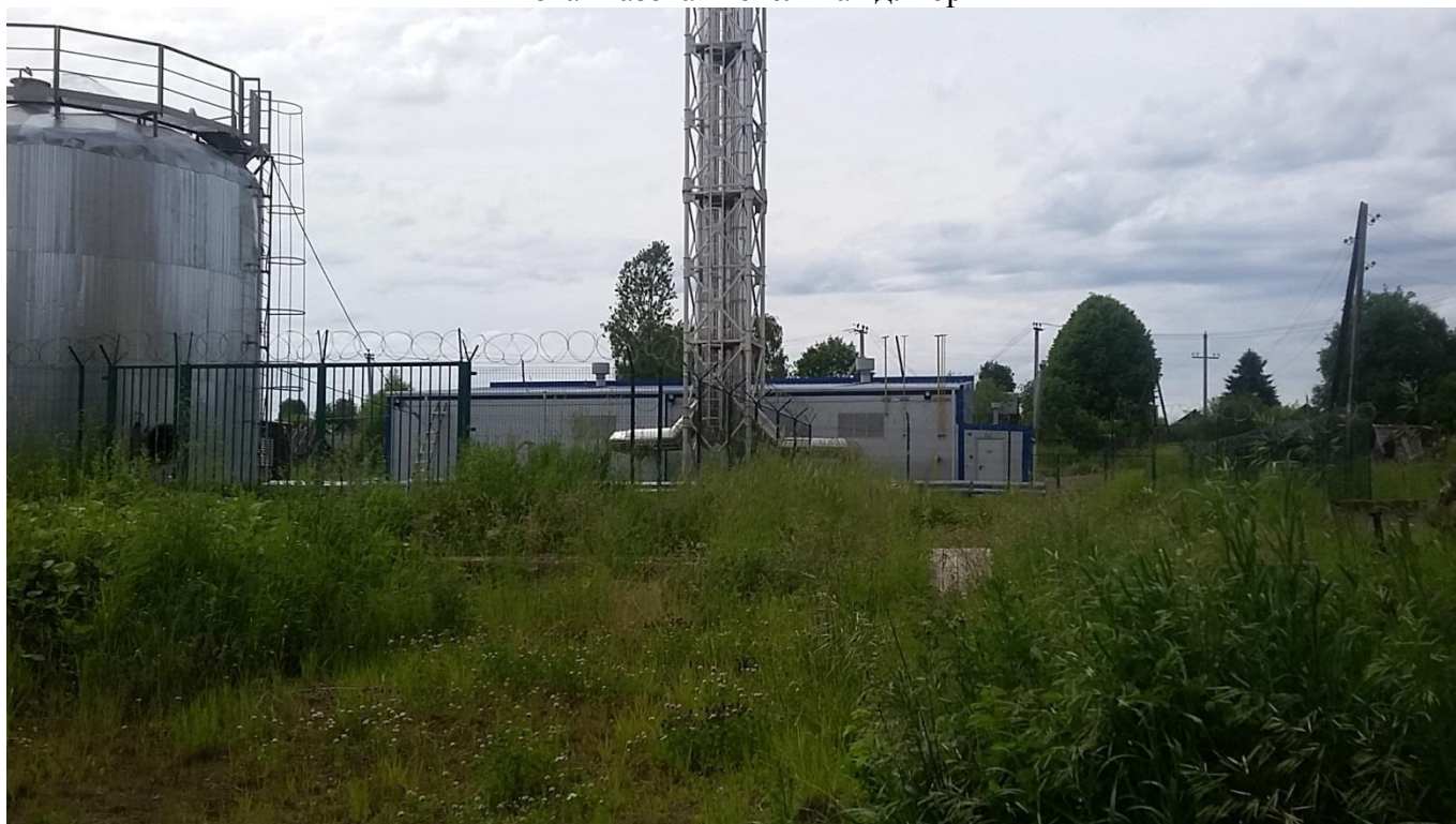
Новая газовая котельная д. Бор
